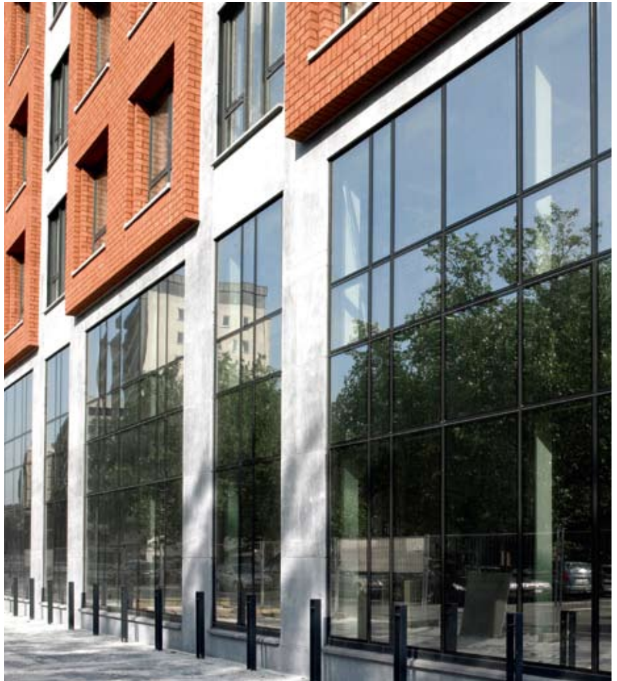
De raampartijen en daklijsten, uit poedergelakt grijs aluminium van Sapa Building System, smelten mooi samen met het geheel.
